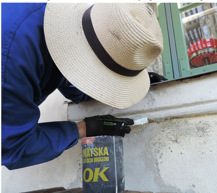
Alla sprickor fylls med kalkspackel
