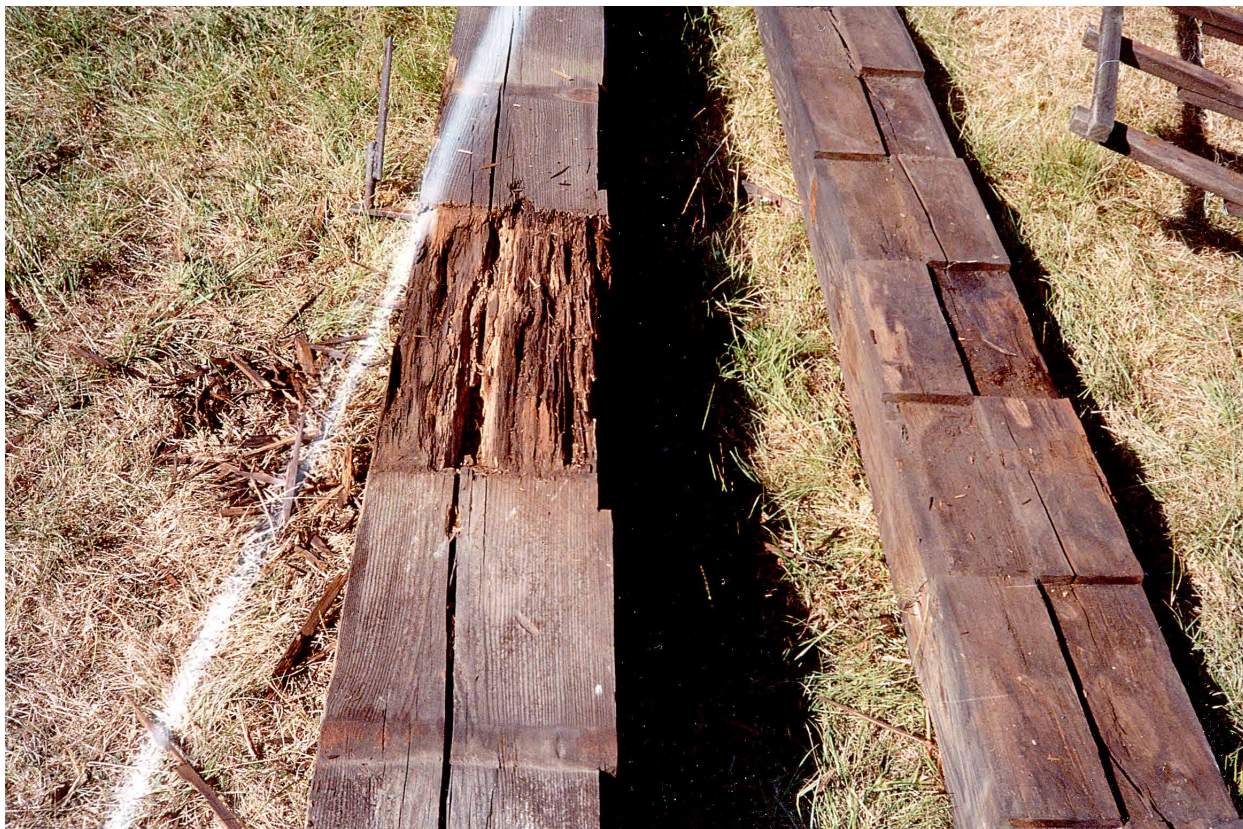
9. Rötskadorna på ena balken.
